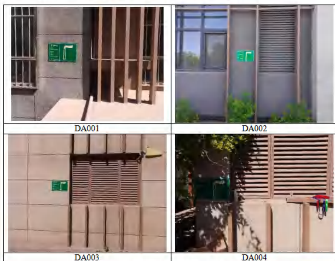
图 3-1 地下车库排风口
