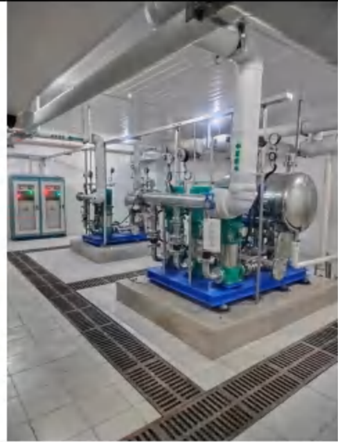
地下设备间减振基础及排水管道减少水流噪声和共振措施
