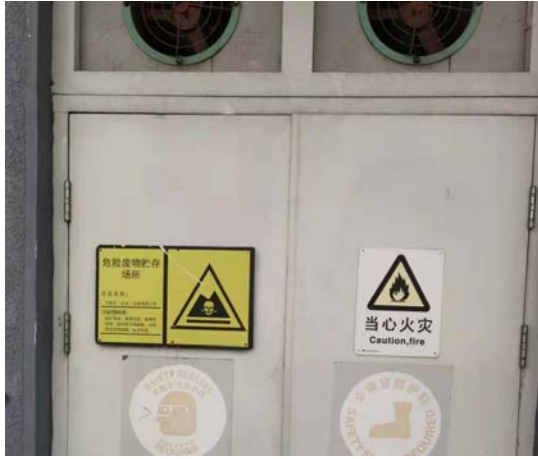
危废暂存间标识
