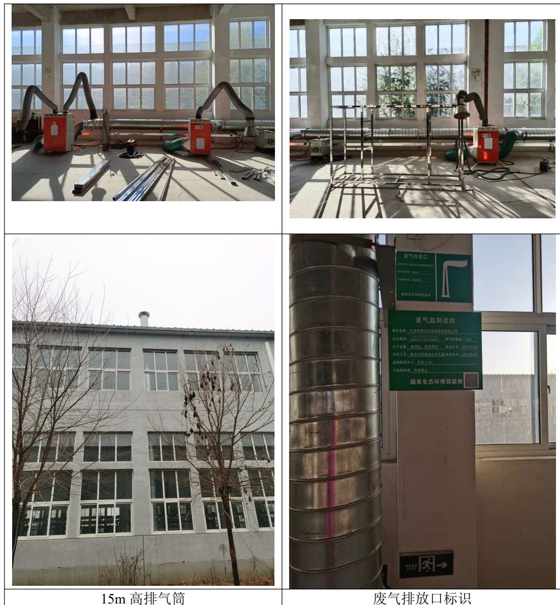
图 3-1 废气处理设施
